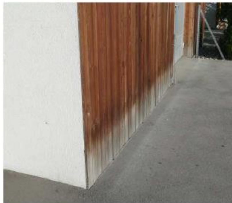
Figura 3.3. Edificio realizzato in legno con elementi esposti (non protetti) al degrado nella zona di attacco a terra
