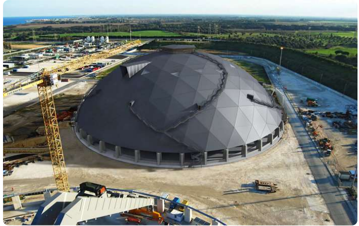
Nodi per la Centrale Enel Federico II di Brindisi
