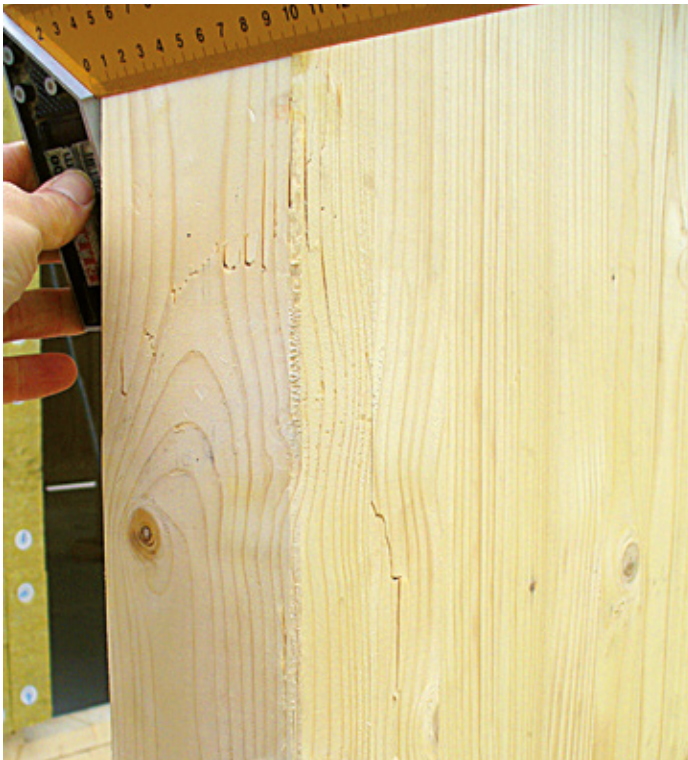
Trave di legno lamellare danneggiata fino a rottura nelle movimentazioni di cantiere (sono visibili le linee di frattura) ed erroneamente messa in opera come pilastro.
